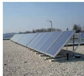
124 m 2 Flachkollektoren Solution
